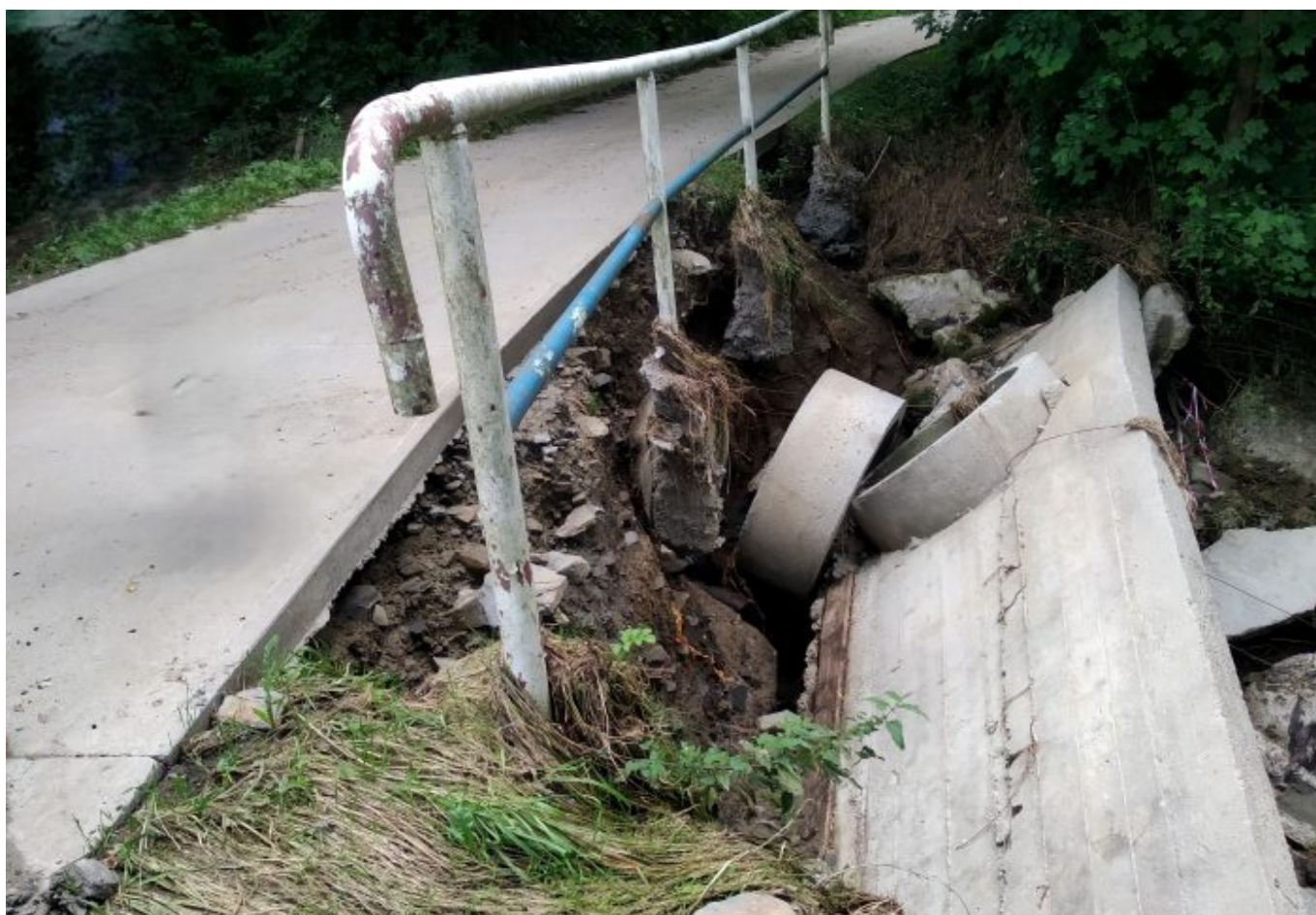
Most w Mogilnie uszkodzony po ulewie.
